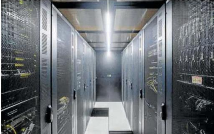
Una sala con servidores de un centro de datos en Madrid. E. R.
