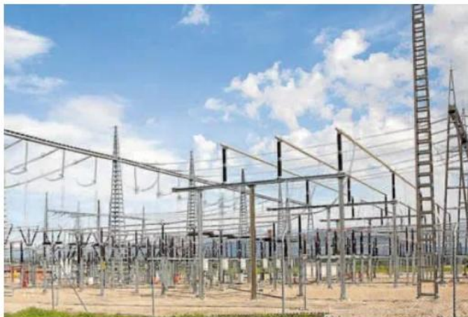
Subestación eléctrica en Segovia. ANTONIO DE TORRE
