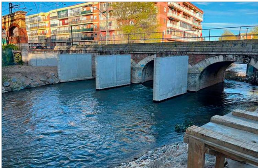
Ejecución de la nueva estructura de la tercera vía del AVE sobre el río Esgueva. E.M.
