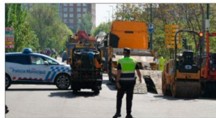
Incidencias de tráfico por las obras en el entorno del puente de Poniente.
